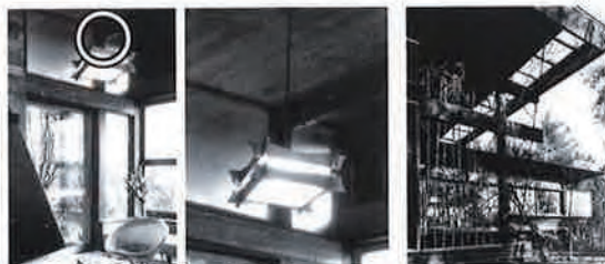
“酒樽の家”の居間の主柱と梁の緊結部○の欄間(ガラスが外れて一気に屋根が…)
