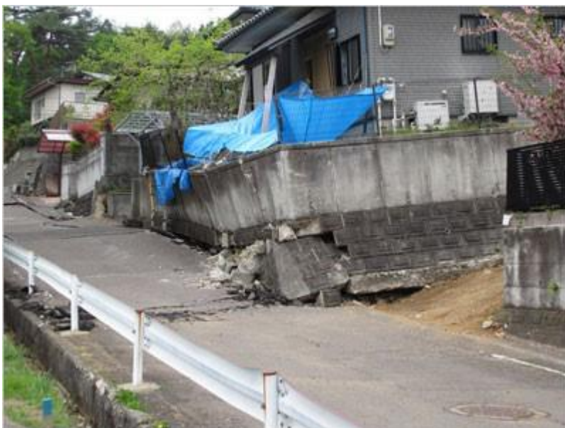
<写真1：地盤から崩れた家>
